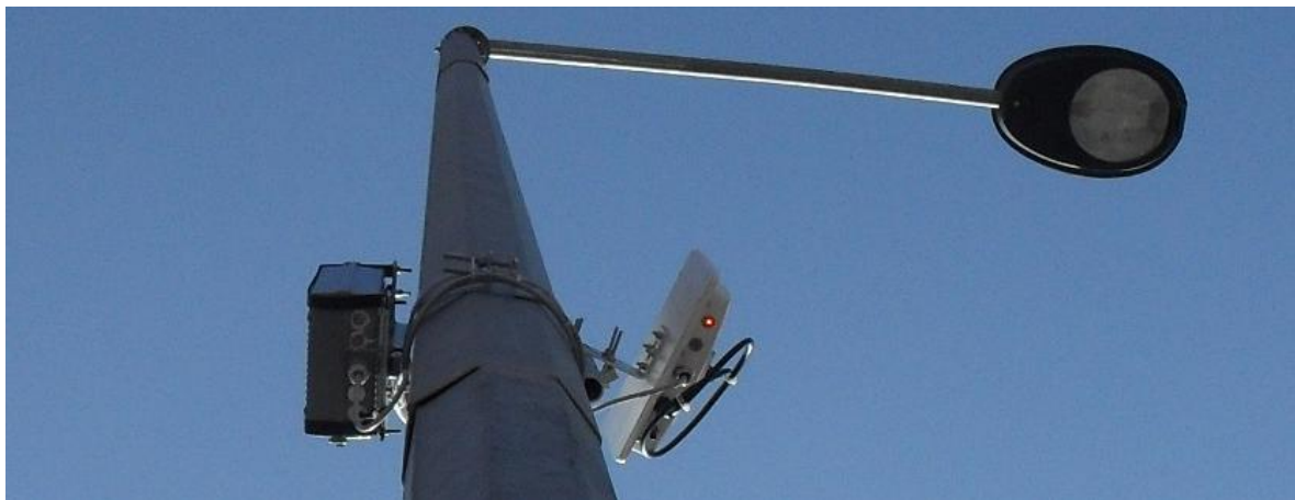
تصویر ۶ - نحوه نصب و استقرار واحد منبع تغذیه RSU (واحد سمت چپ)
